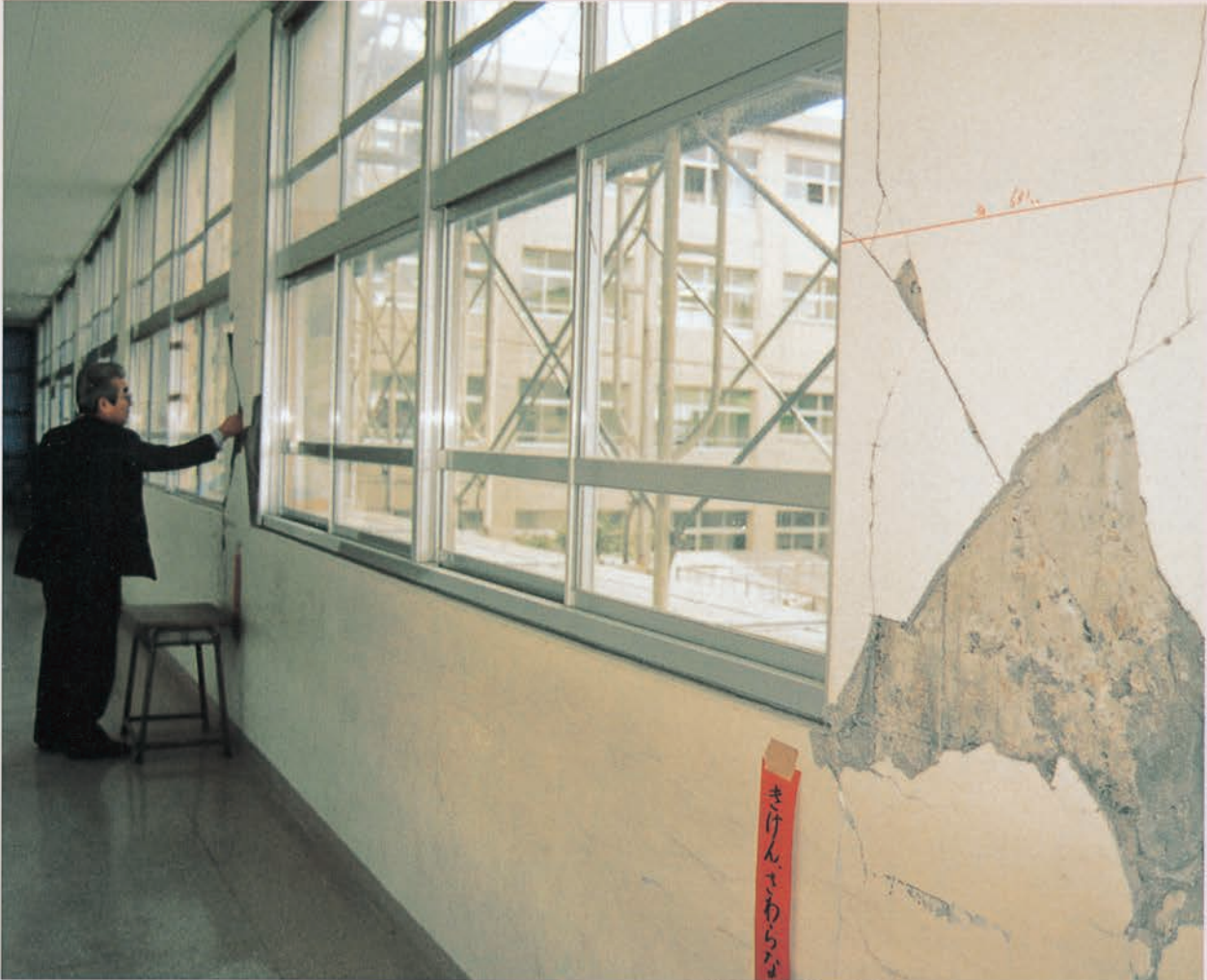
震災直後の花園小学校。壁のはく離や亀裂が生々しい
