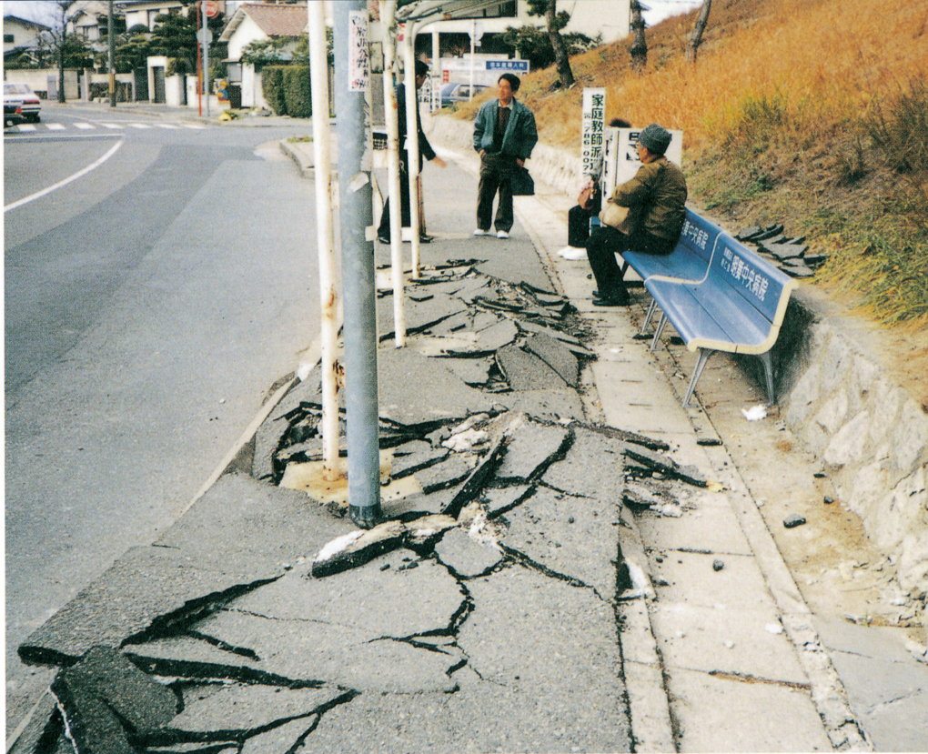
アスファルトがめくれあがったバス停(松が丘2丁目)
