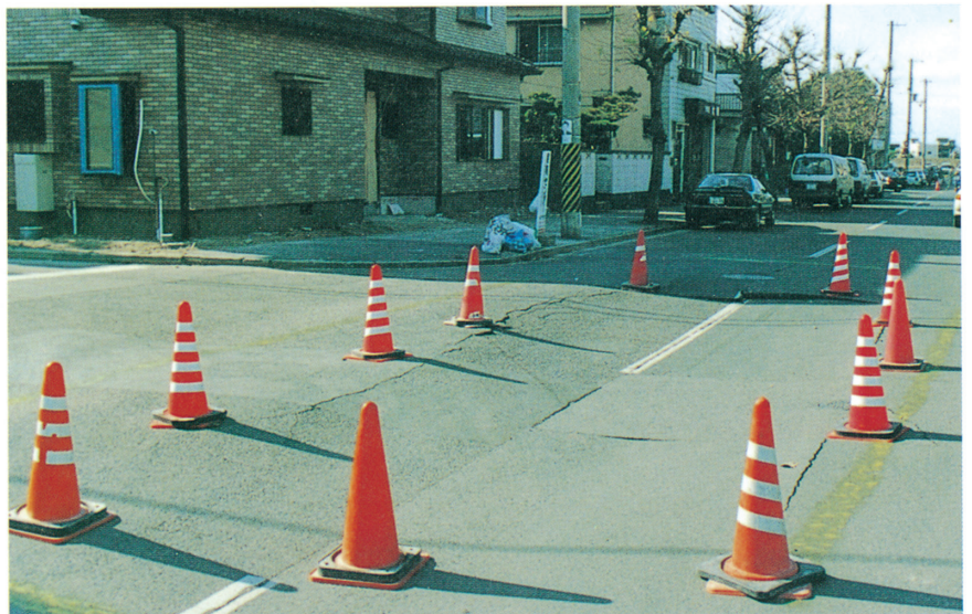
大きく陥没した道路(岬町)
