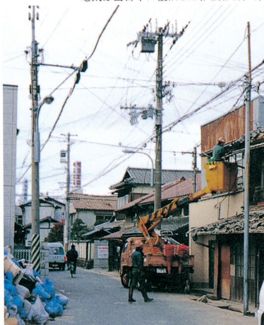
電気は当日中に復旧した(大蔵天神町)
