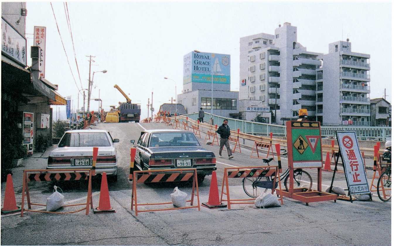
フェリー乗り場へ通じる錦江橋も通行止めに(本町1丁目)
