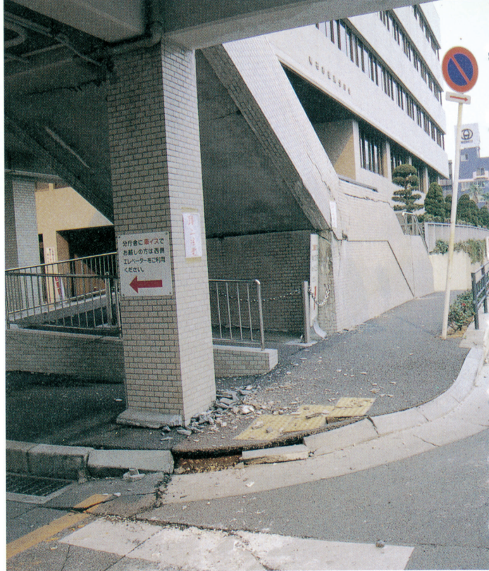
市内各所の道路で亀裂が入るなどの被害がでた(市役所前の市道)
