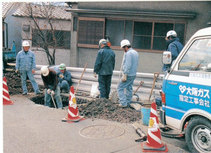
市内各地でガス管が破損し、明石川以東で供給が停止された(大蔵中町)
