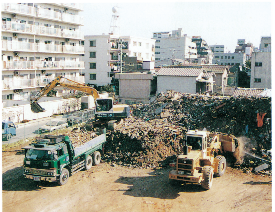
空き地に集められたガレキの山(大明石町2丁目)
