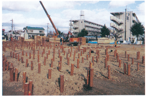
仮設住宅の建設は急ピッチで進められた(大久保町谷八木)
