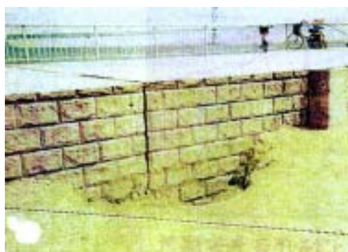
[ケーソン 11 - 12]陥没状況
