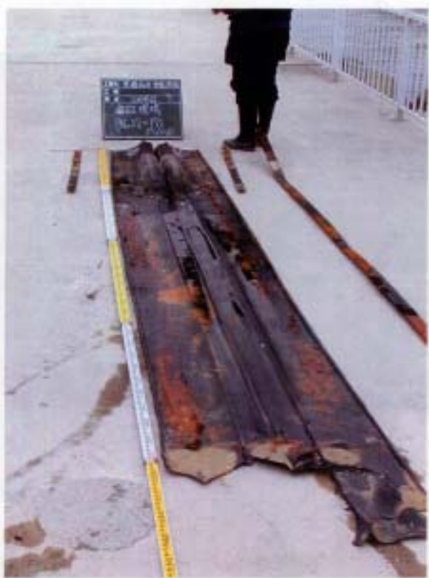
写真-3.5 事故箇所 No.17-18 防砂板
