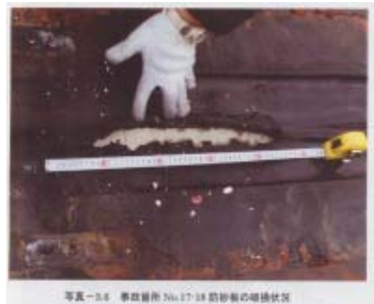
写真-3.6 事故箇所 No.17-18 防砂板の破損状況
