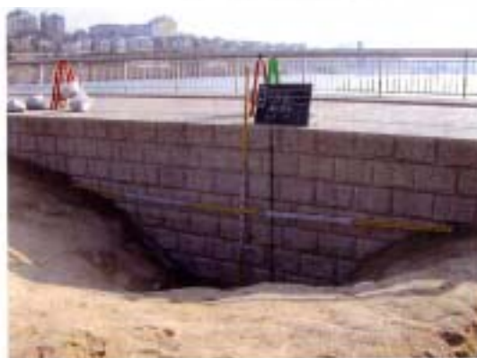
写真- 1.1 事故現場（「大蔵海岸 陥没事故調査報告書」から転載）
