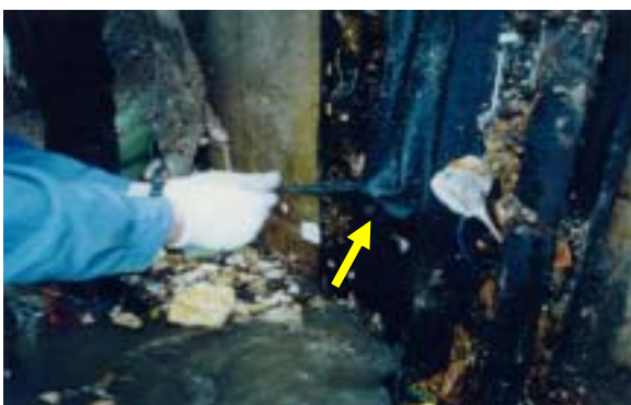
防砂板の亀裂(矢印)を確認
