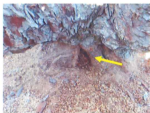
随所に腐朽箇所（菌糸）を確認
