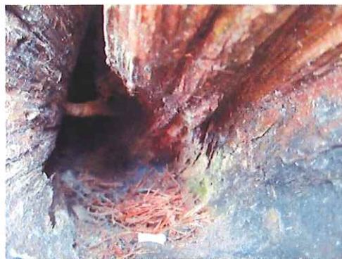
開口空洞内部（心材が腐朽崩壊）
