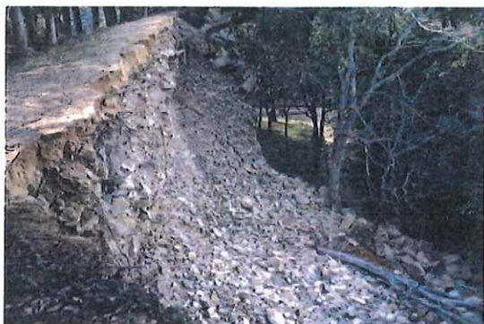
震災で崩れた二ノ丸の北辺石垣
