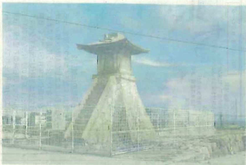
フェンスに囲まれた明石港の旧波門崎燈籠堂。貴重な文化財ながら活用は進まず、劣化も目立ち始めた＝明石市港町
