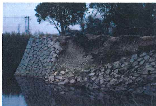
震災で崩れた薬研堀石垣
