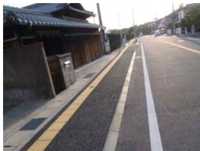
【歩道の波打ち解消】
