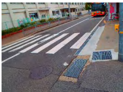
【すべりにくいグレーチングや コンクリート床板の設置】
