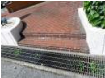
出入口の付近の段差
