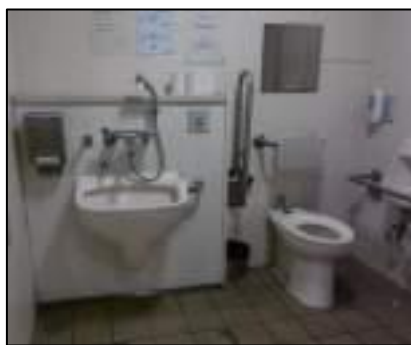
駅構内の多目的トイレ
