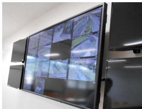
【大型ディスプレイ、定点観測カメラの事例（武雄市役所）】
