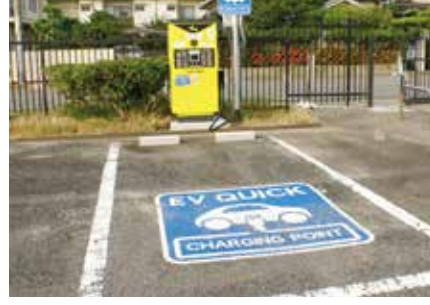
電気自動車の充電スポット
