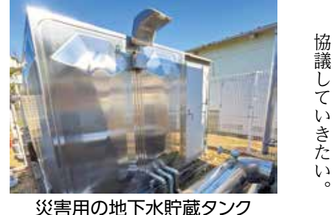
災害用の地下水貯蔵タンク
