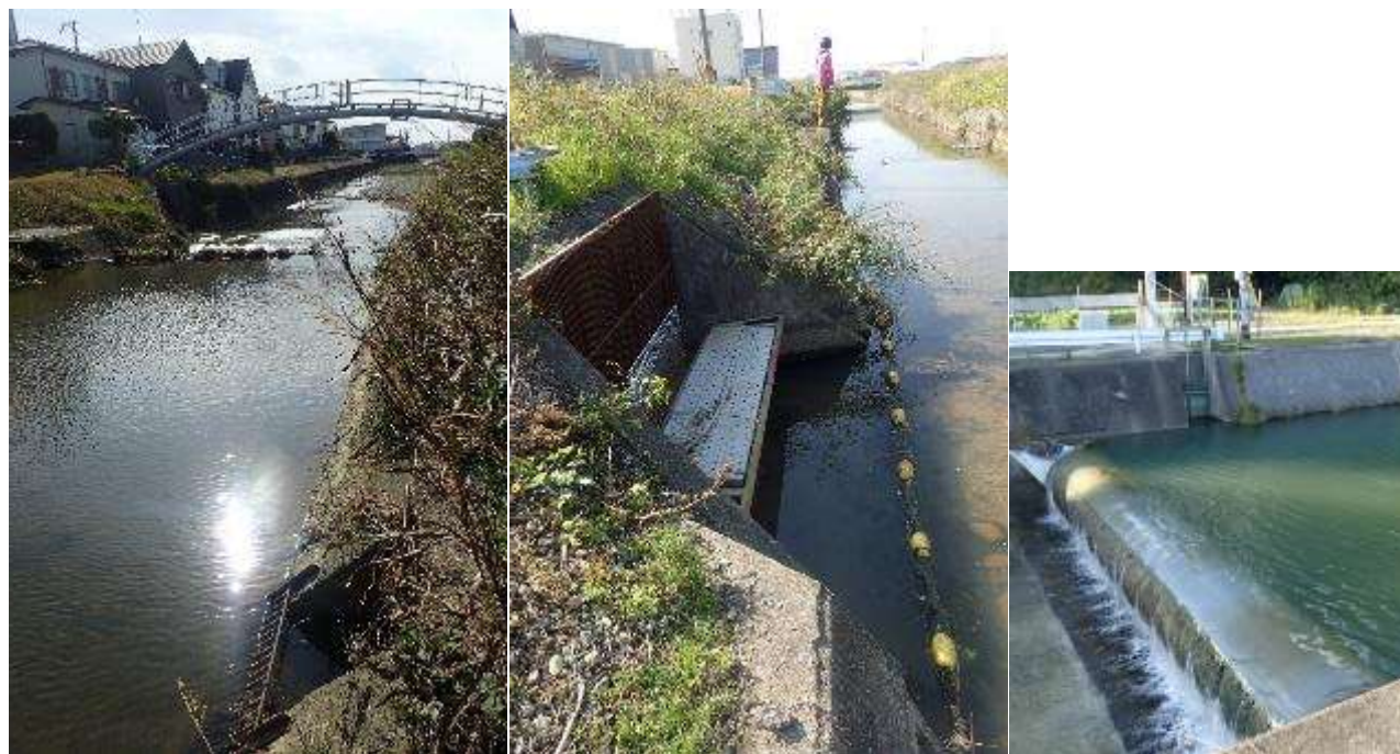
図 3.3.2d 瀬戸川水系の河川内からため池へ取水する取水口
