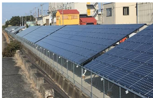
南二見人工島の太陽光発電設備
