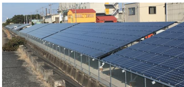
南二見人工島の太陽光発電設備
