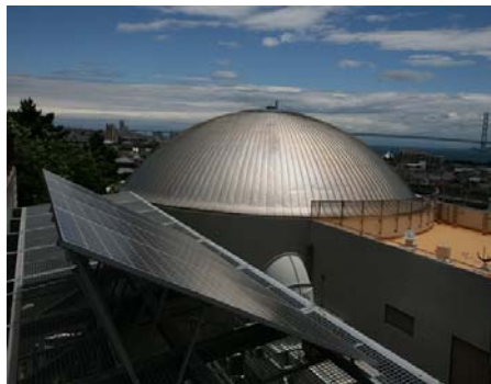
図 4-2 公共施設への太陽光発電設置
