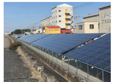
南二見太陽光発電施設
