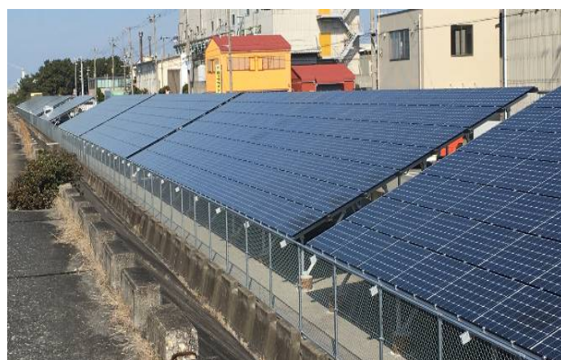
南二見人工島の太陽光発電設備
