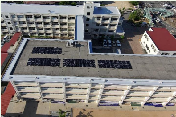
人丸小学校屋上の太陽光発電設備
