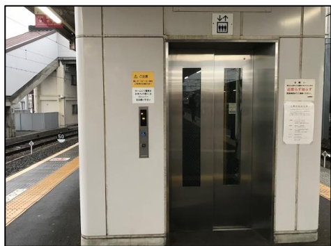
駅構内のエレベーター
