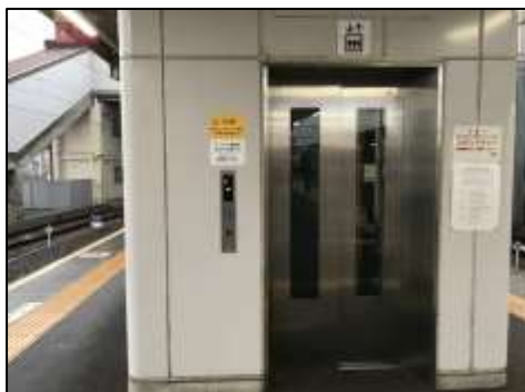
駅構内のエレベーター
