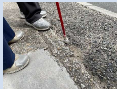
県道:舗装の凹凸
