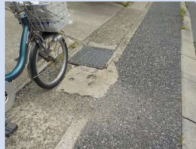
県道:舗装の凹凸
