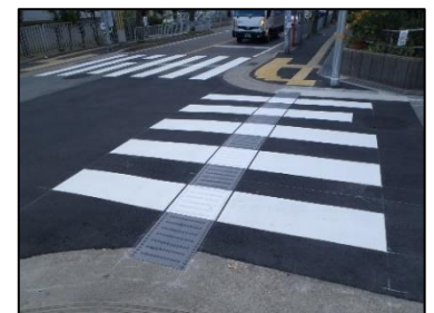
(総合福祉センター周辺のエスコートゾーン)
