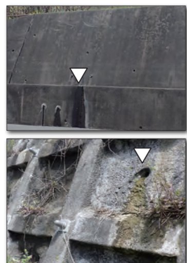
地下水の流出
