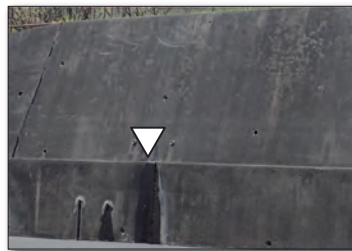
地下水の流出
